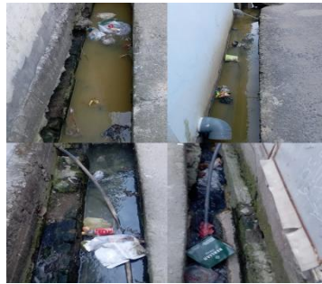
Gambar 2. Sampah yang menyumbat saluran drainase sehingga menghambat aliran air (Sumber : Dokumentasi Penelitian, 25/05/2026).
